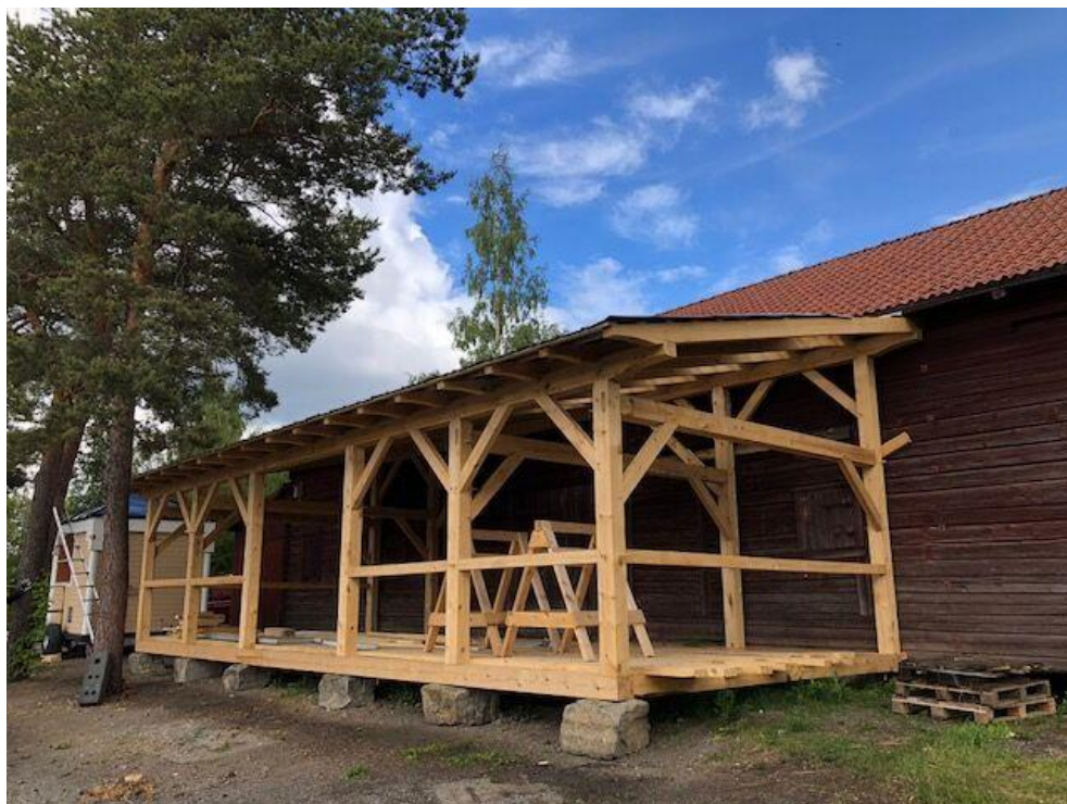
Ett användbart utrymme med vacker utsikt. Foto MA.
